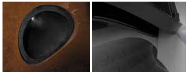
Vista dall'interno di una condotta in gres: La guarnizione non sporge all'interno del tubo
